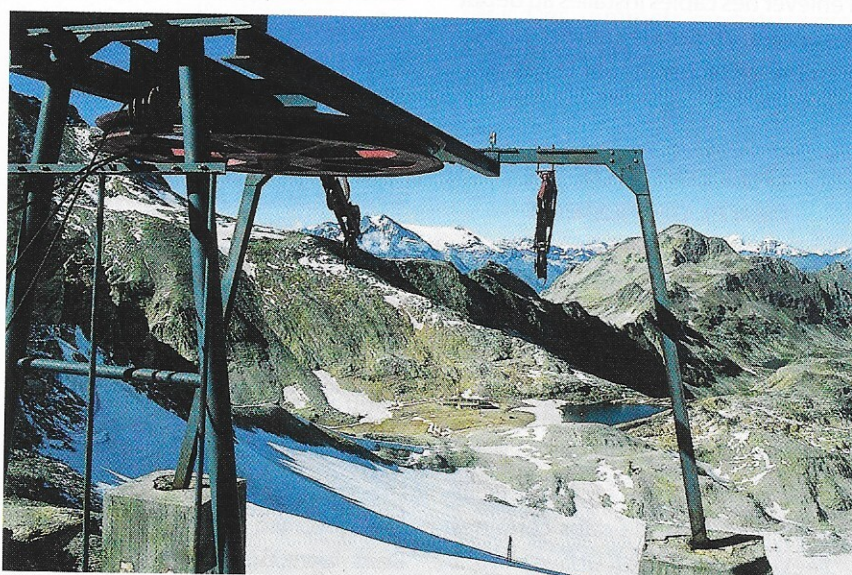
☛ Une des installations à l'origine de la campagne « installations obsolètes » de Mountain Wilderness
